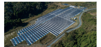
S-62 茨城北茨城 太陽光発電所
